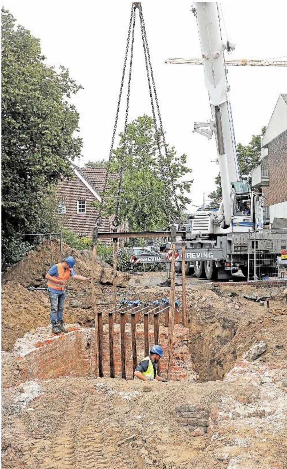
Mit einem Spezialgestell wurde der zehn Tonnen schwere Fundamentbrocken aus der Tiefe geborgen. (2) Stroetmann
